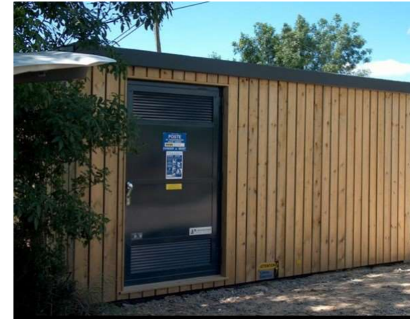
Photographie 25 : Exemple d'un poste de livraison avec bardage bois (source : sel-solution)
